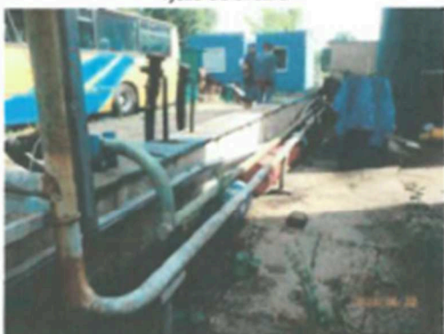
potrubí k nádržím, jímka
