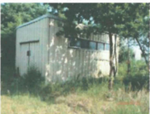
regulační stanice plynu
